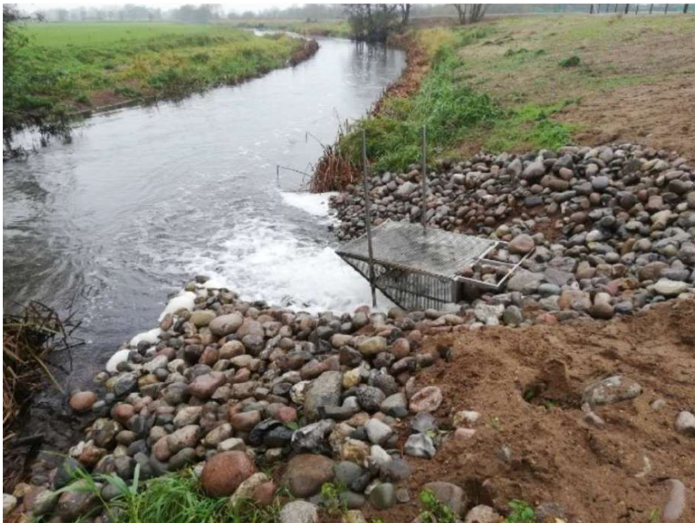
Figur 2. Billede af et tilsvarende udløbsbygværk som bygges ved dambruget i Gels Å, billedet er fra Jedsted Fiskeri.
